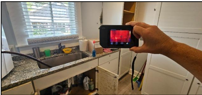
29. Moistuer behind wall
