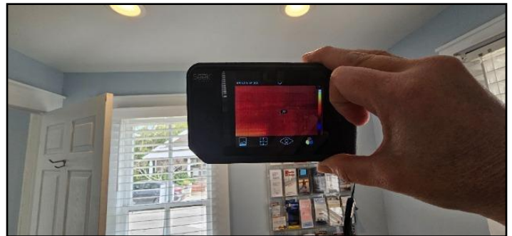
30. Moisture above window
