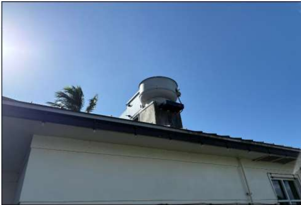
Kitchen Ventilation Fan
