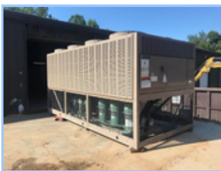
Compass - AC Chiller.jpg
