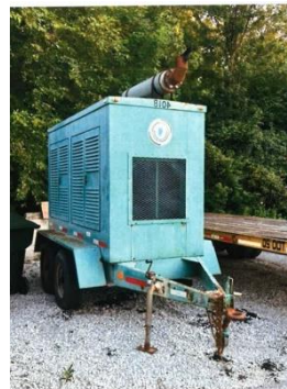
*Old 100kw Kohler towable generator*
