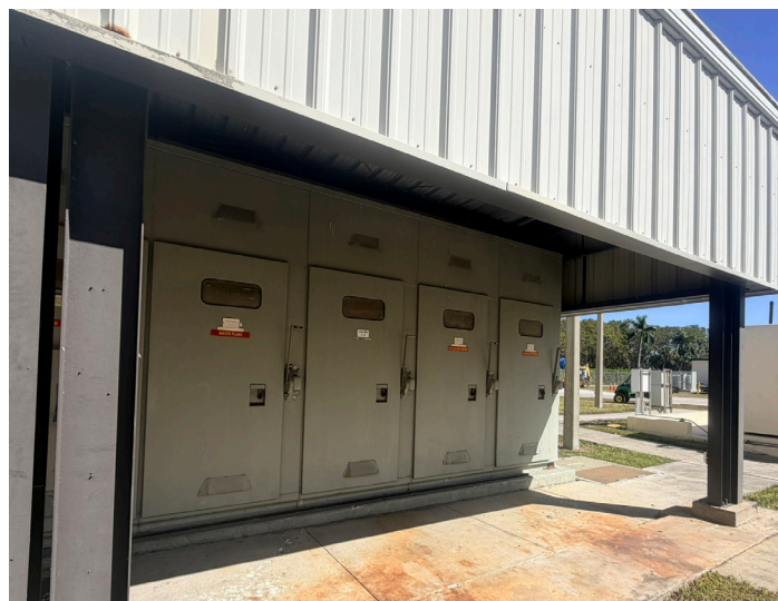
Switchgear MV 5 SWGR
